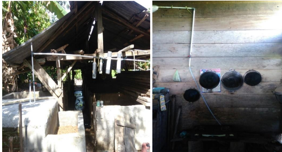
Gambar 3a dan b. Sistem instalasi pemipaan biogas untuk keperluan memasak
