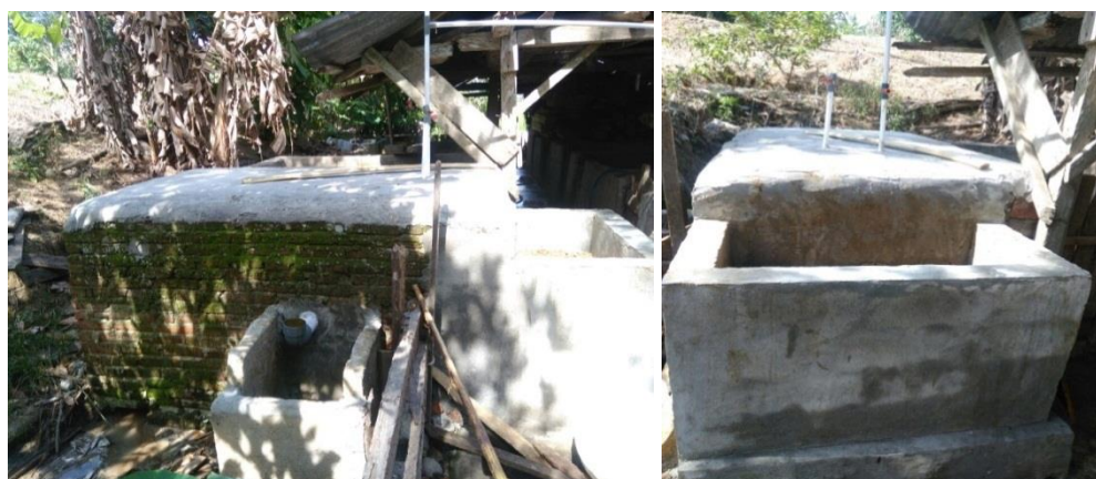
Gambar 2.a dan b. Digester biogas yang dibangun di desa Kosio
